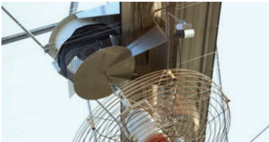
▲ Proefopstelling in Wageningen UR. Combinatie van twee ventilatoren die de lucht door het schermdoek brengen. (bron: www.energiek2020.nu )
