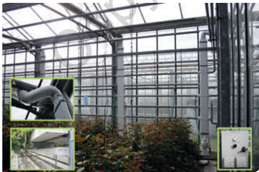
▲ Aanzuiging van droge lucht boven de schermdoeken (enkel als de schermen dicht zijn). Detail A: flexibele buis als aanzuigleiding doorheen het scherm, detail B: uitblaasleiding onder de teeltgoot, detail C: bediening met klok, temperatuur- en vochtregeling.
