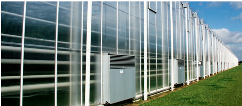
Luchtbehandelingskasten in gevel in combinatie met Het Nieuwe Telen
