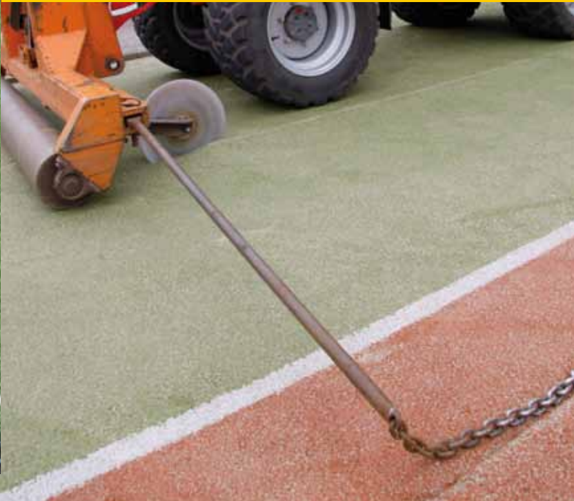
Var verwijdert bij TC De Linden in Beuningen een kunststof tennismat. De mat wordt in banen gesneden door een snijder aan de voorkant van de shovel.
