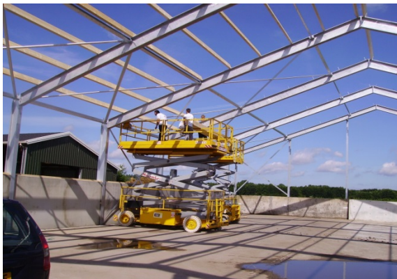
Bouw nieuwe schuur voor opslag van voer en strooisel, Hoeve Biesland. (Foto Mieke Duijndam).
