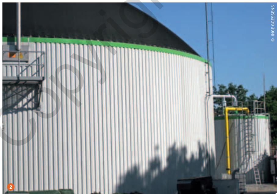
1 De bedrijfswagen van de Duitse vergister Biomethan Mühlacker rijdt op 'eigen' groen gas. 2 Om biogas te mogen injecteren in het aardgasnet of te kunnen gebruiken als vervoersbrandstof, is een verdere opzuivering tot biomethaan nodig.
