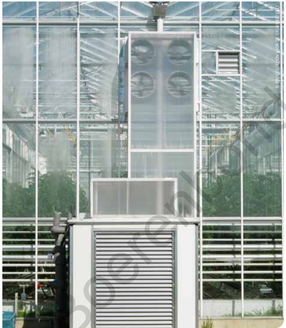
Een luchtbehandelingskas brengt de ingeblazen lucht op de gewenste temperatuur en/of luchtvochtigheid.
