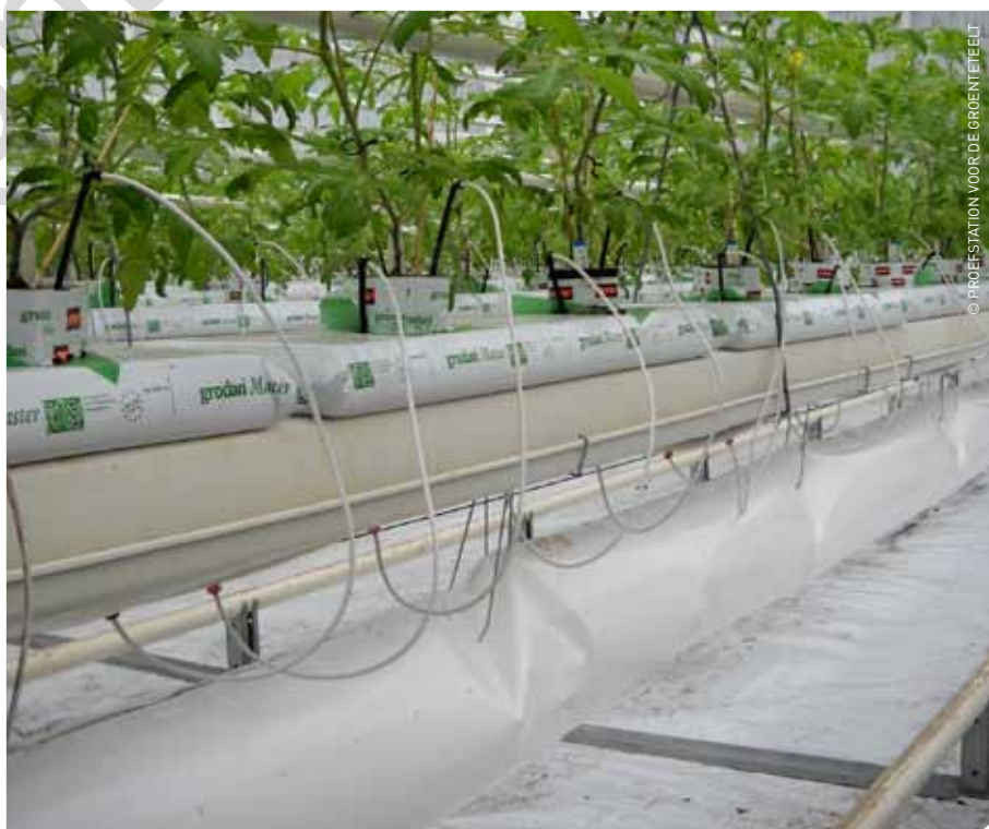
Luchtslangen onder de teeltgoten verdelen de geconditioneerde lucht in de serre.
