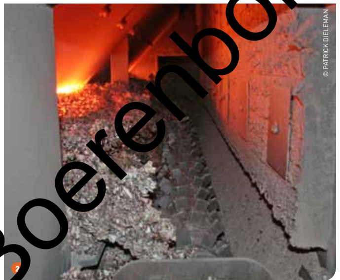
1 De tuinder kan alle relevante waarden aflezen op de touchscreen-monitor van zijn antracietketel. 2 Een duwsysteem schuift de opgebrande assen op naar de automatische ontassingsvoorziening.
