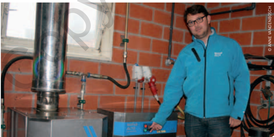
Birger Vansever van Nilfisk-Alto toont de Duo Booster, een vaste reinigingsinstallatie met 2 pompen, in de technische ruimte van het bedrijf Bernaerts. De brander (links) zorgt ervoor dat warm water beschikbaar is voor het reinigen.
