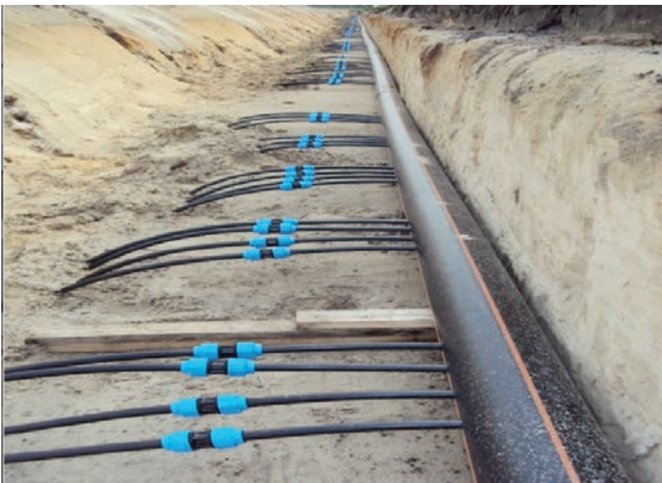
Figuur 2. Slangenbuffer en distributieleiding (Foto Cogas Zuid).
