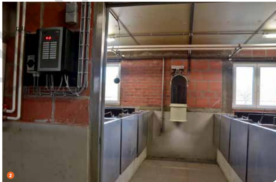
1 De centrale gang van de nieuwe biggenbatterijen. 2 In alle hokken wordt het klimaat individueel geregeld.
