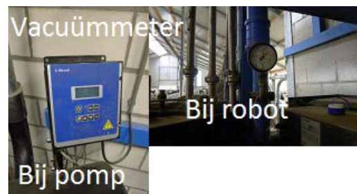
Figuur 4: Vacuümmeter bij de robot en de vacuümpomp (machinekamer, robot)
