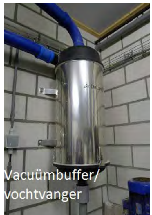
Figuur 2: Vacuümbuffer/vochtvanger (machinekamer)
