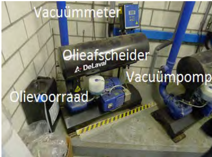
Figuur 1: Vacuümpomp (machinekamer)
