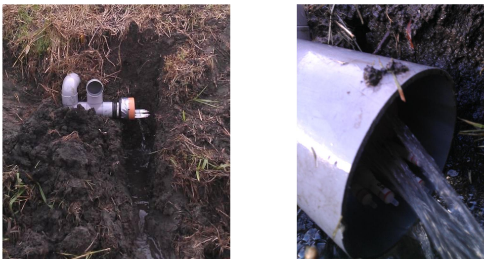
Figuur 4.15: De Flow-Cap geïnstalleerd op de drain in Zeewolde, rechts in een grotere buis als beschermkap.
