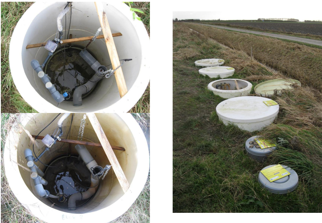
Figuur 4.8 Verzamelvaten met uitgang verzameldrain, pomp, en opstelling met Sorbisense systeem en ion-selectieve elektroden. Verzamelvat van ondiepe drain (boven) vertoont geen ijzeraanslag, verzamelvat van diepe drain (onder) wel.
