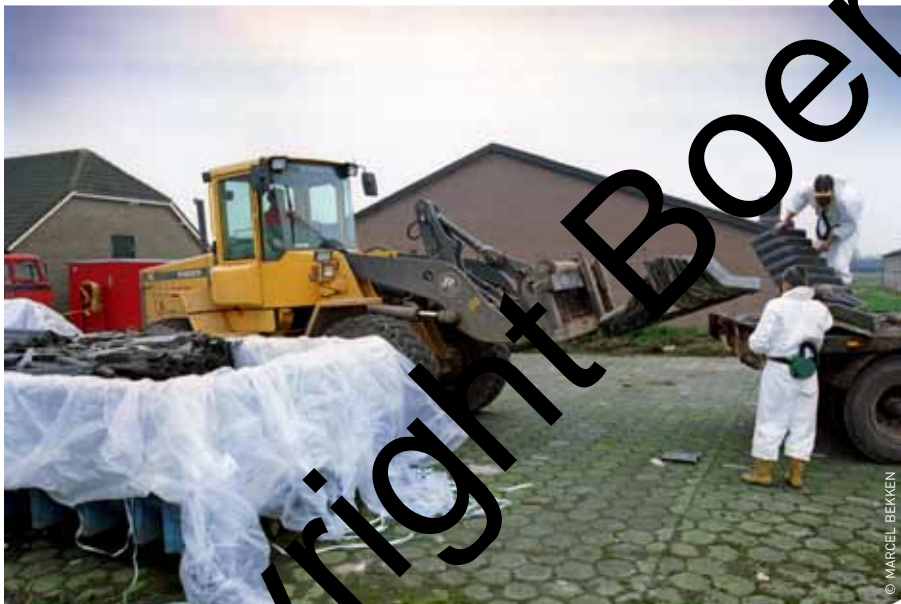
Gebruik bij het verwijderen een geschikt stofmasker en draag een wegwerpoverall. Sla het asbestmateriaal op in een gesloten verpakking en breng het naar het containerpark, een vergunde stortplaats of laat het ophalen door een erkend overbrenger voor gevaarlijk afval.
