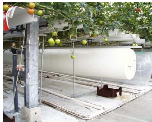
Figuur 5 Onder hangende goten is ruimte voor koeling en verwarming met luchtbeveging
