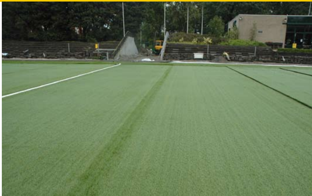
Gelijmde stukken kunstgrasveld DHC. De matten liggen aan een zijde op een lijmschijf.
