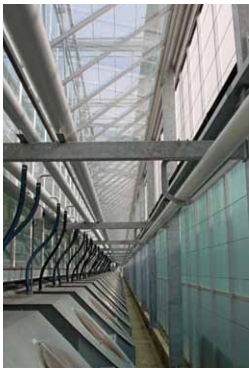
Tientallen ventilatoren voeren de aangezogen kaslucht via warmtewisselaars op de juiste temperatuur terug in de kas.
