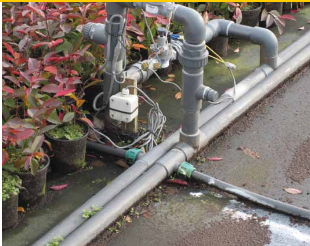
De binnen- en buitenzijde van de regenleiding en het doek van het containerveld kunnen besmet zijn met Xap en Psm
