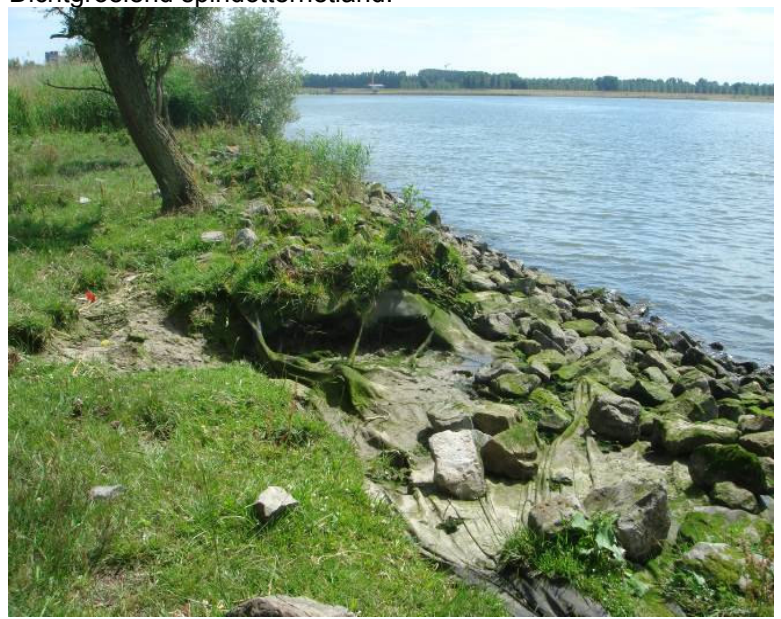
Plaatselijk beschadiging vooroeververdediging (noord).
