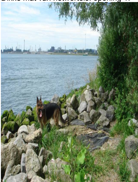
Plaatselijk beschadiging vooroeververdediging (midden).
