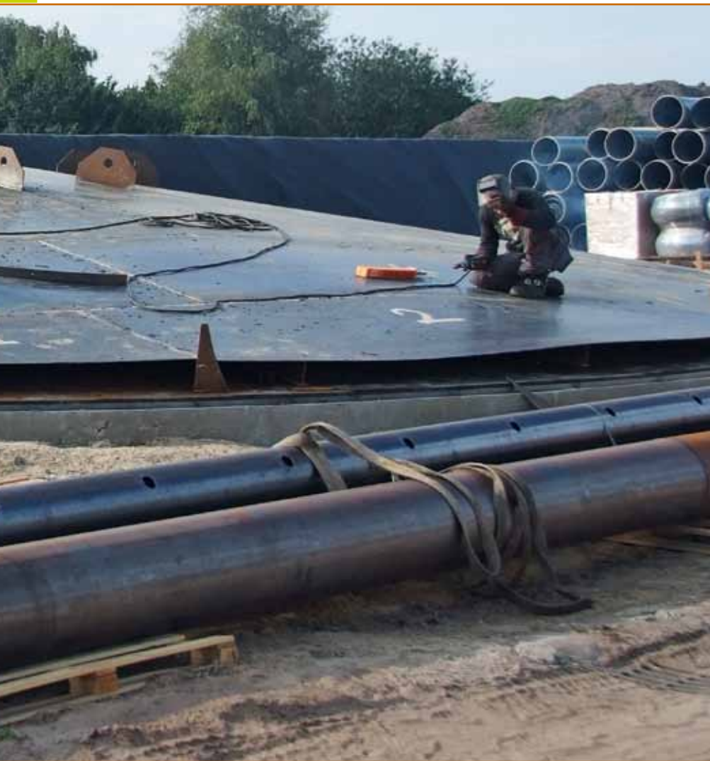
Eén van de twee nieuwe warmte-opslag tanks wordt gebruikt voor opslag van laagwaardige warmte.
