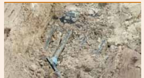
Het warmteopslagnet op drie meter diepte: 110 kilometer slangen die de restwarmte van de WKK bergen.
