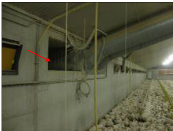
Pijl: uitstroomopening van de warme stallucht richting de warmtewisselaar Buizen: instroom verwarmde buitenlucht uit de warmtewisselaar naar de dieren
