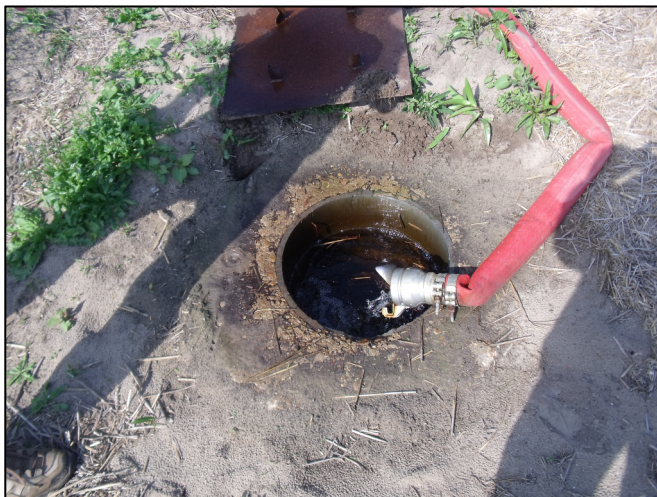
Figuur 29 Een drainageput wordt van zoetwater voorzien via de op het bedrijf aangelegde persleiding.
