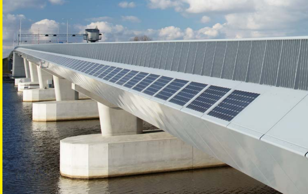
320 zonnepanelen op de Ramspolbrug.
