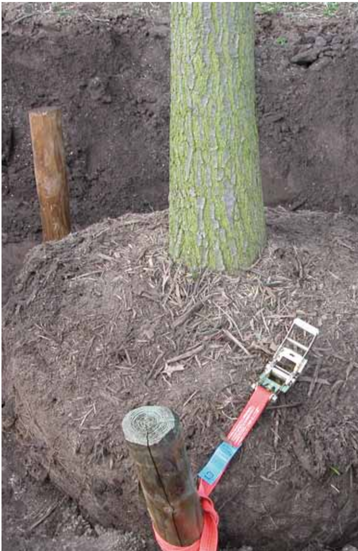
08 De palen stevig vastzetten met spanbanden. Deze ook goed in de palen vastslaan.
