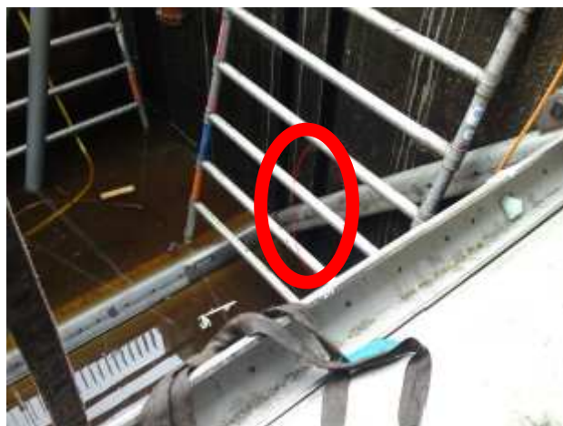
Figuur 4.1 Bouwfoto FishTrack waarop alleen het frame van het fijnrooster gemonteerd is. De sponning waar Aal kan passeren is omcirkeld in rood. Deze plek is op 26 oktober 2011 opgevuld met hout zodat hier geen passage meer mogelijk is.
