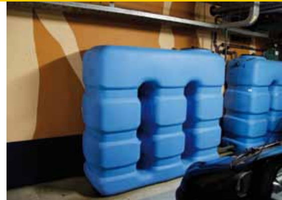
Watertanks in de parkeerkelder
