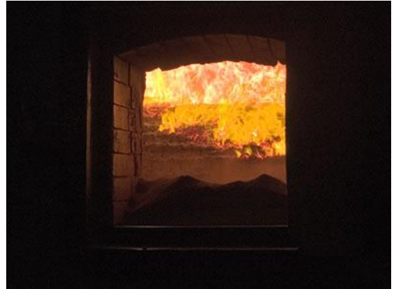
figuur 5.5.2. ► verbrandingsruimte biomassacentrale Lelystad
