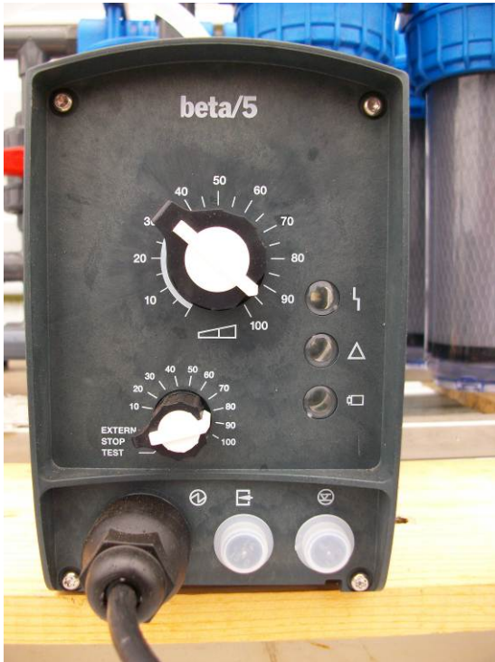
Figuur 11 Doseerpomp met een ingesteld debiet van 15 liter per uur
