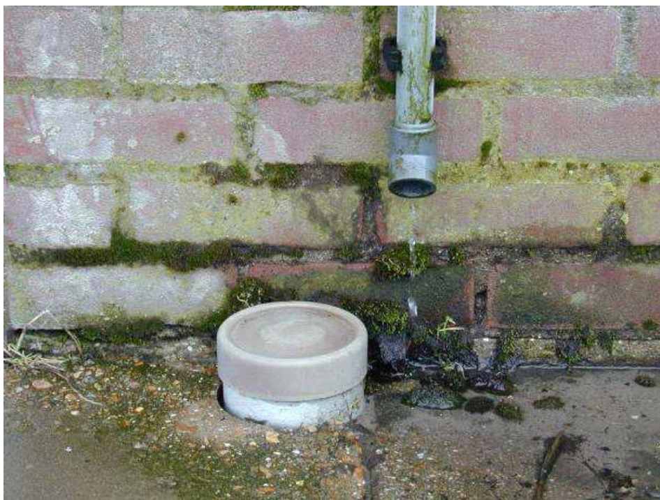
Figuur 1 Voorbeeld van een condens afvoer aan de buitenzijde van een bewaarcel
