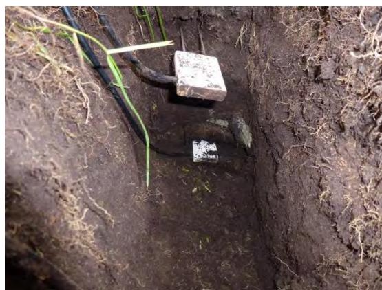
Foto 2.3 Detail plaatsing vochtsensoren
