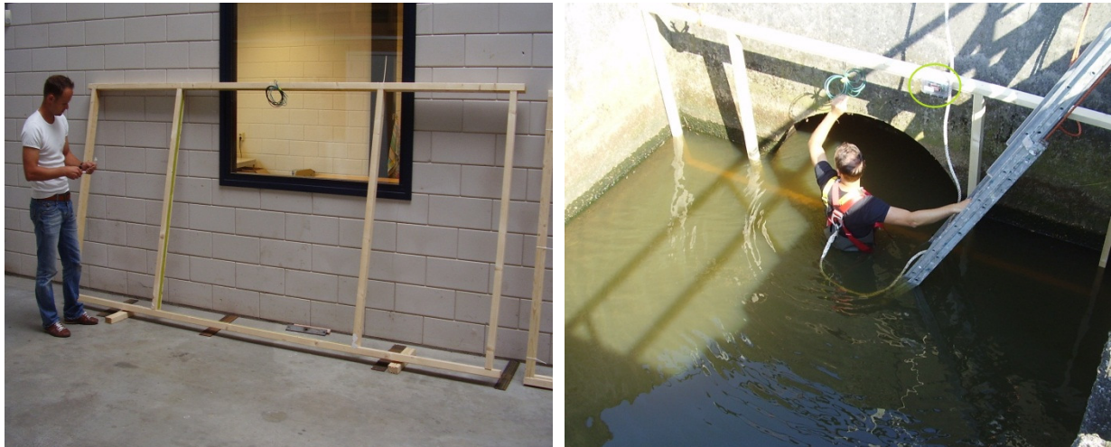
Figuur 2.3. Opbouw van het detectiestation: (links) voorwerk in de loods; (rechts) opbouw aan de benedenstroomse zijde van de sifon. Groen omcirkeld: 'waterproof marker tag'.
