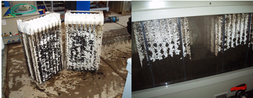
Figuur 4.5: vervuiling lamellenpakketten (links), vervuiling in lamellenpakketten na aflaten proefinstallatie (rechts)
