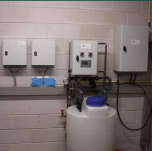
De gehörige pompen hoeven nu niet langer in de technische ruimte te worden geplaatst
