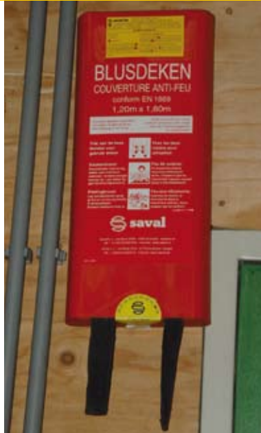
Deze branddeken naast de deur is goed vindbaar.
