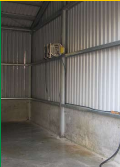
Overdekte spuitplaats met leiding- en beregeningswater.
