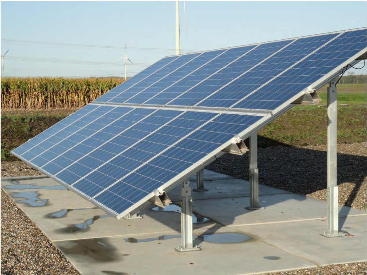
Foto 5: Solarpark panelen in de vaste opstelling
