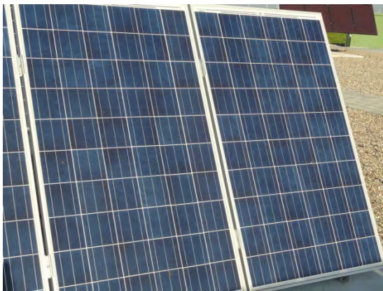
Foto 1: polykristallijn silicium panelen van Solarpark
