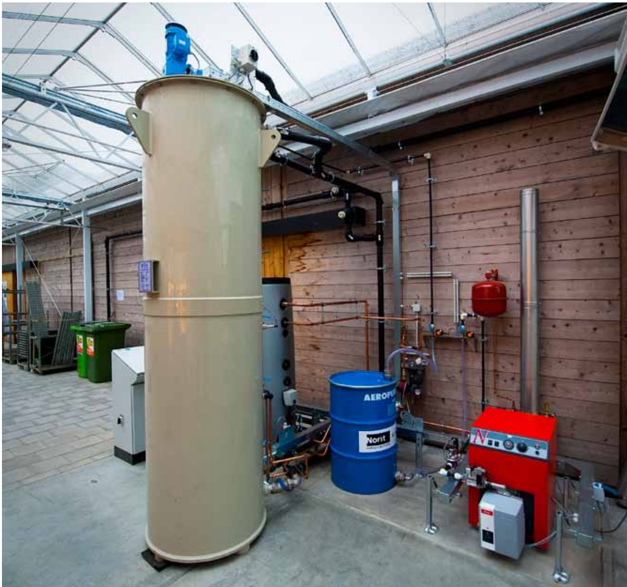
Anaerobe vergister bij het NIOO in Wageningen, voor de zuivering van 'zwart water' onder productie van biogas.
