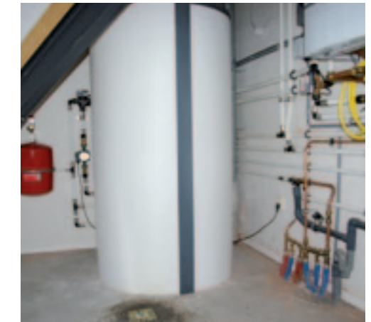
▲ In de woning komt een buffervat te staan, waarin het warme water wordt opgeslagen.
