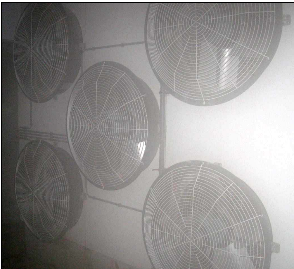
Ventilatoren (drukkamer vóór de wasser)
