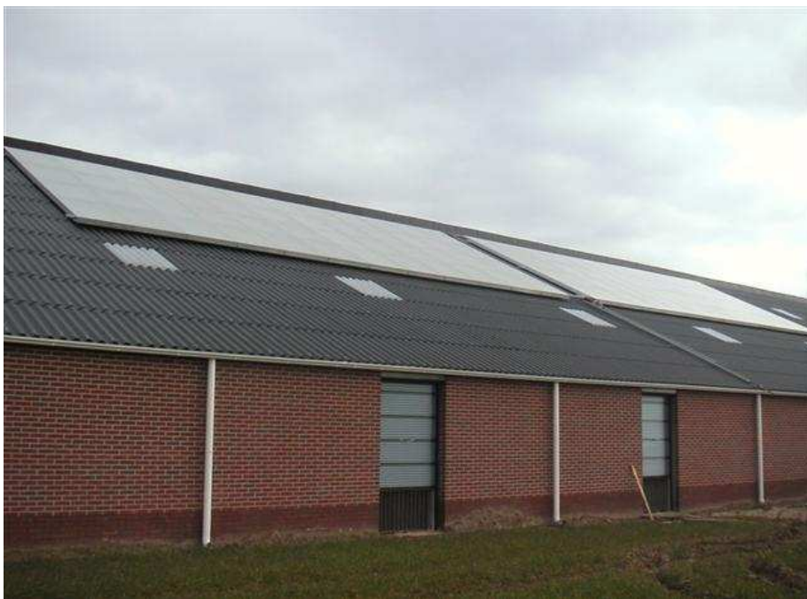
Figuur 1 Vleeskalverenstal met zonnecollectoren op het dak voor de productie van warm water. Bij grote (ca. 7 m 2 ) collectorunits kunnen collectoren tot ca. 130 m 2 aan elkaar gekoppeld worden met één aan- en afvoerleiding.
