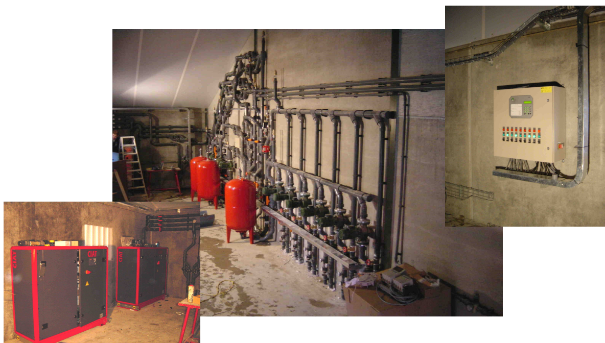
Figuur 3. Linksonder foto van warmtepompen, middenfoto: verdeelsysteem met drukkettels en rechterfoto: besturingskast warmtepomp en vloerverwarming-/koeling.
