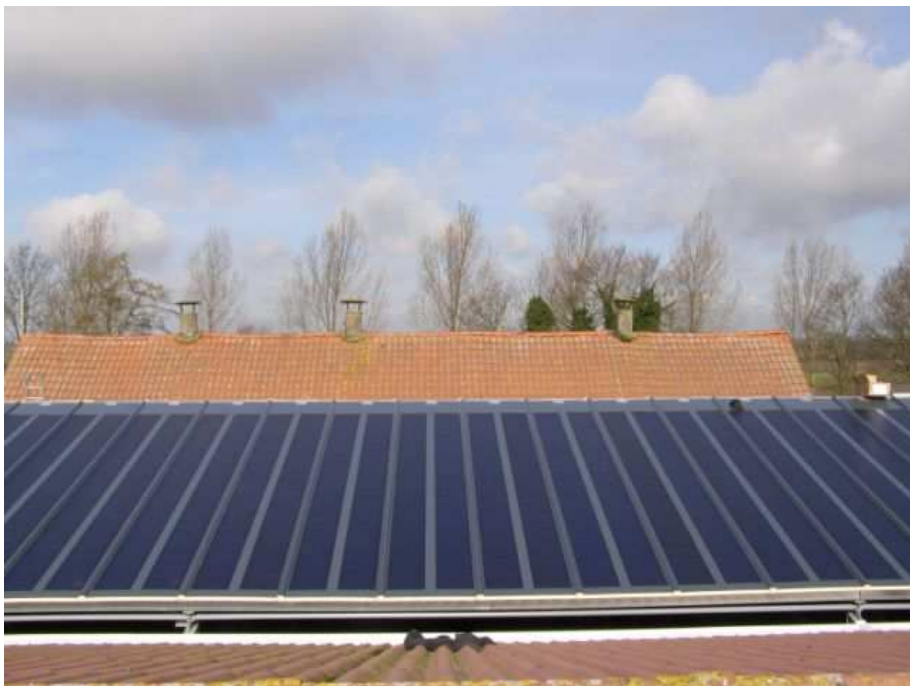
Figuur 3 toepassing van flexibele PV-panelen gemonteerd op stalen dakbedekking, voor een lager gewicht. Op dit moment is deze combinatie duurder dan afzonderlijke PV-panelen geplaatst op een bestaande of afzonderlijk te plaatsen dakbedekking.
