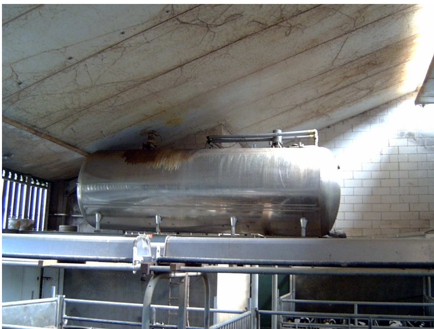
Figuur 2 Vleeskalverhouderijstal met een gebruikte melktank voor de tijdelijke buffering van warm water uit een zonnecollector op het dak. Bij het gebruik van speciale veelal verticaal opgestelde goed geïsoleerde warm waterbuffertanks is een iets groter rendement mogelijk doordat onderin de tank het op te warmen water kouder is, waardoor de warmtewisselaar van de cv-ketel de warmte af kan geven bij een lagere gemiddelde watertemperatuur. Oudere koeltanks hebben veelal een iets minder goede thermische isolatie omdat het te overbruggen temperatuurverschil geringer is.
