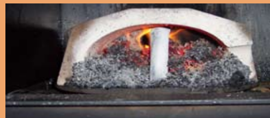
Een biomassa gestookte cv-ketel vergt meer onderhoud dan een gasgestookte ketel. Zo is het nodig om regelmatig asresten uit de ketel te verwijderen.
