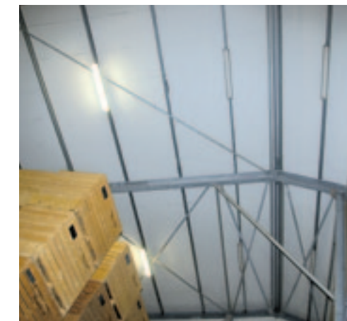
▲ Het dakvlak met een dubbele schoring, wordt stijf door extra staanders met windverbanden.
