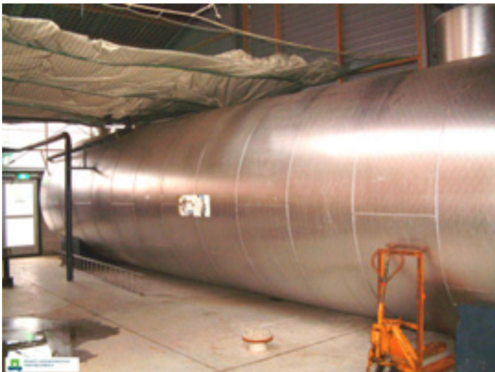
Foto 5: De liggende propstroomvergister met daarboven de gaszak
