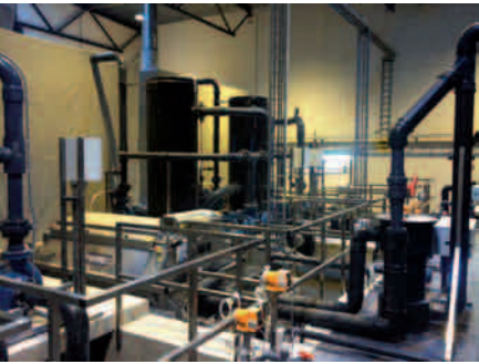
De installaties bij HESY.
