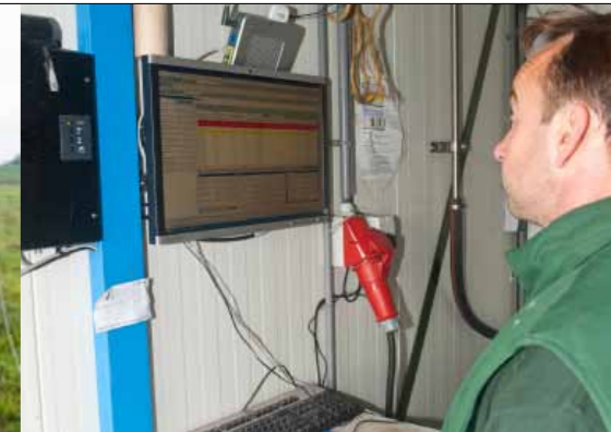
In de unit is ook een computer aanwezig
