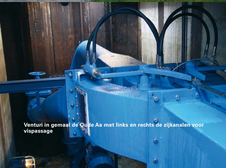
Gemaal de Oude Aa, het eerste gemaal dat voorzien is van een Manshanden gemaalvispas
