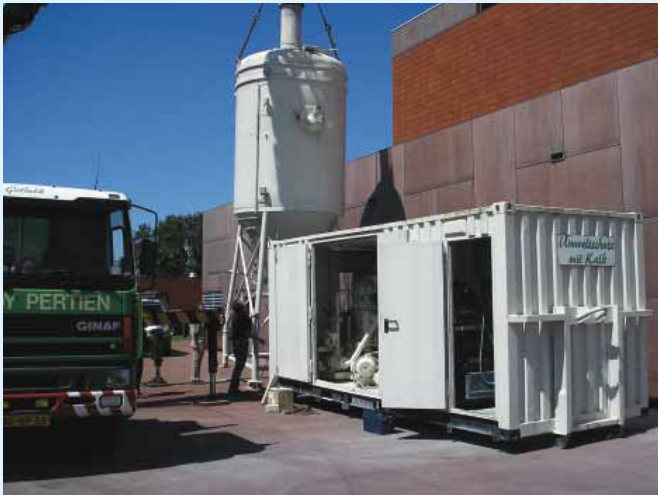
De proefinstallatie voor de aanmaak van kalkmelk.
