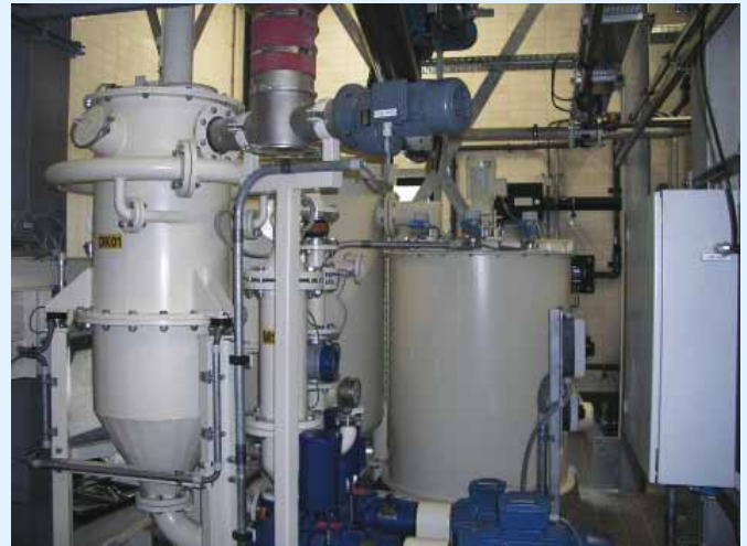
De definitieve installatie van de kalkmelkaanmaak.
