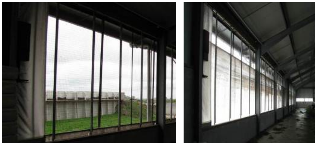
Figuur 2 Links: inlaatopening zoals bij normale bedrijfsomstandigheden wordt gebruikt. Rechts: verkleining van de inlaatopening. In dit voorbeeld stond de wind pal op de inlaat, waardoor de inlaat voor een groot deel afgesloten was. Aan de andere zijde van de stal was de inlaatopening minder gesloten.
