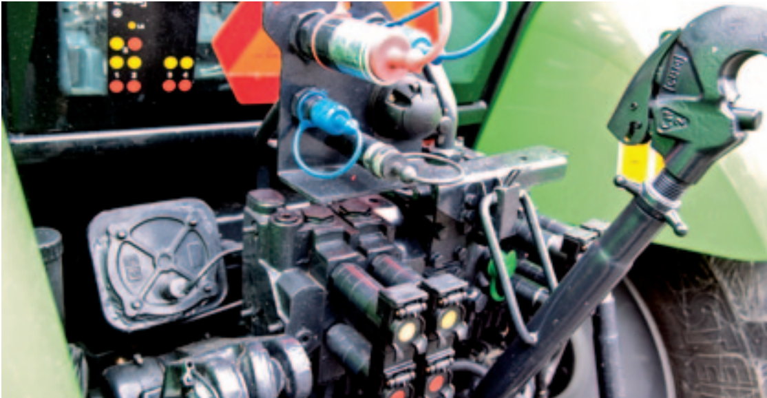
Elektrisch bediende DW-ventielen zijn standaard en vanuit de cabine instelbaar op doorstroming en tijd.
