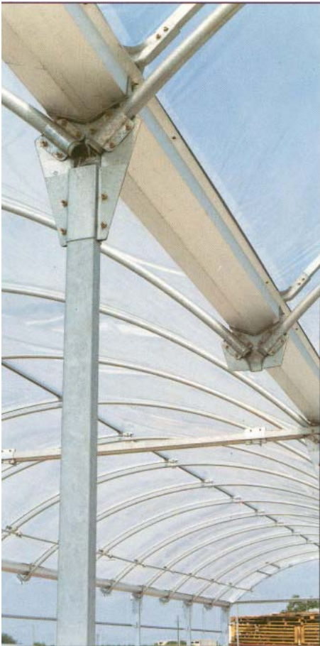
Figuur 25. Door toepassing van dragende goten ontstaan aanééngesloten teelruimten (Ininsa).
