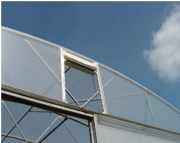
Figuur 74. Extra ventilatie door raamopening in de kopgevels bij foliekas in Roggel.
