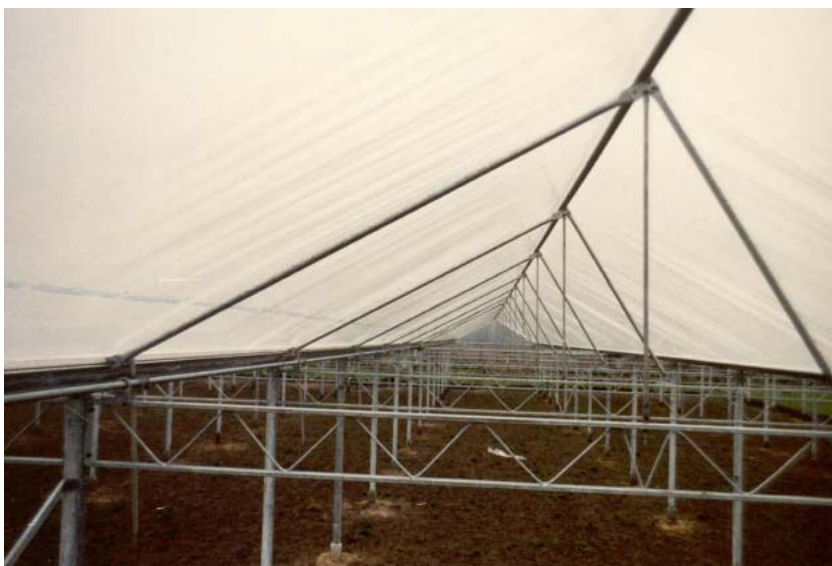
Figuur 46. Door het gebruik van gespannen folie als omhulling zijn minder schaduwgevende constructiedelen nodig dan bij glas (Foto Waaijenberg).
