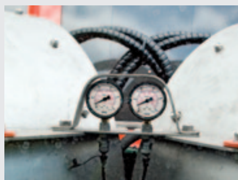
Twee manometers geven de druk in de blowers aan. Is die laag, dan is een ventilator verstopt of vervuult.
