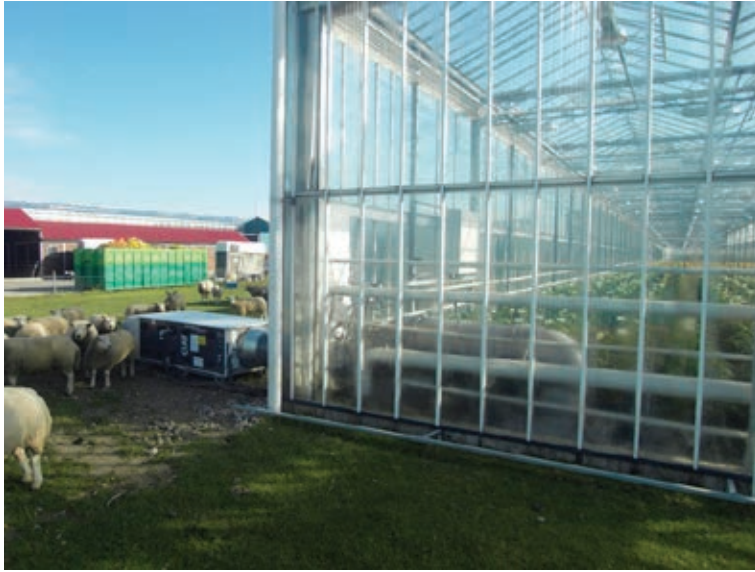
Figuur 2.8. Luchtbehandelingskast buiten.
